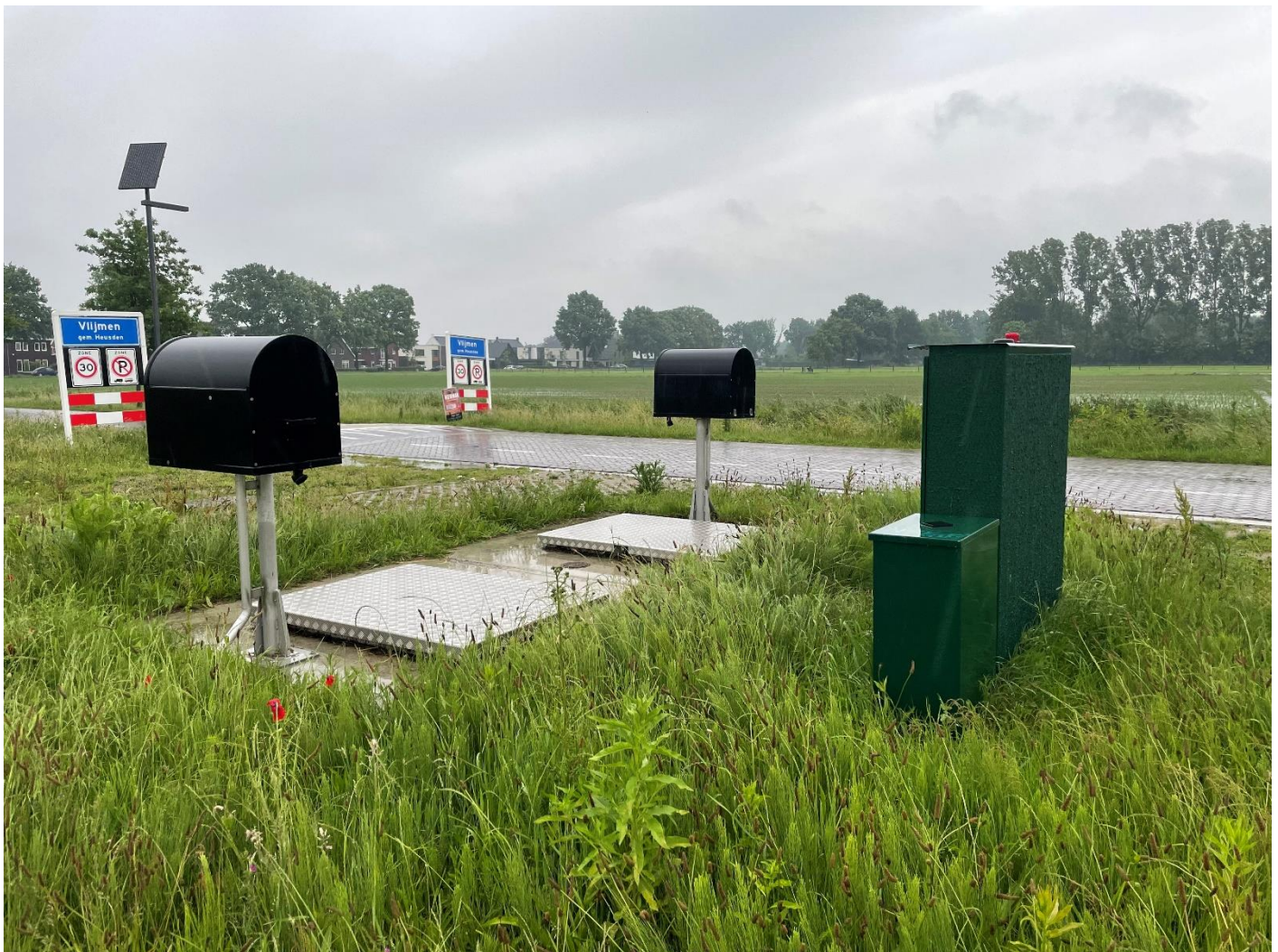
Pompen en schuiven regelen dat de waterlussen goed doorstromen met oppervlaktewater
