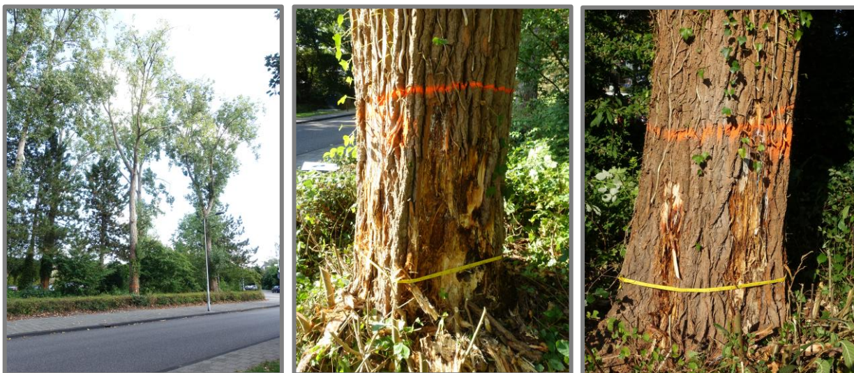
Fig. 6: Bij boom 6 is het grootste deel van de stamvoet en stambasis reeds afgestorven waarna er omvangrijke houtrot is ontstaan. De houtrot bevindt zich niet alleen bovengronds, maar ook ondergronds in de wortelkluut. Het is van belang deze boom met spoed te kappen.
