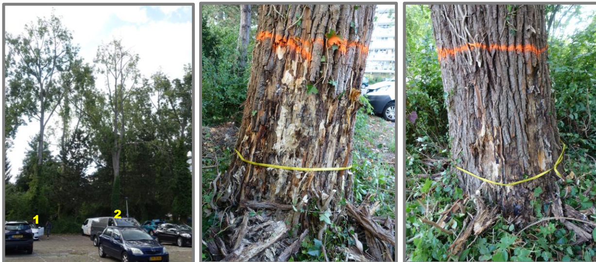
Fig. 1: Bij boom 1 is rondom de stamvoet en stambasis omvangrijke houtrot ontstaan. De boom vormt een acuut risico voor de gebruikers van het parkeerterrein. Geadviseerd wordt om de boom met spoed te kappen.
