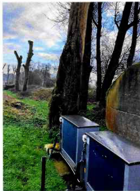
Figuur 8: Elektrische apparatuur naast boomstomp
