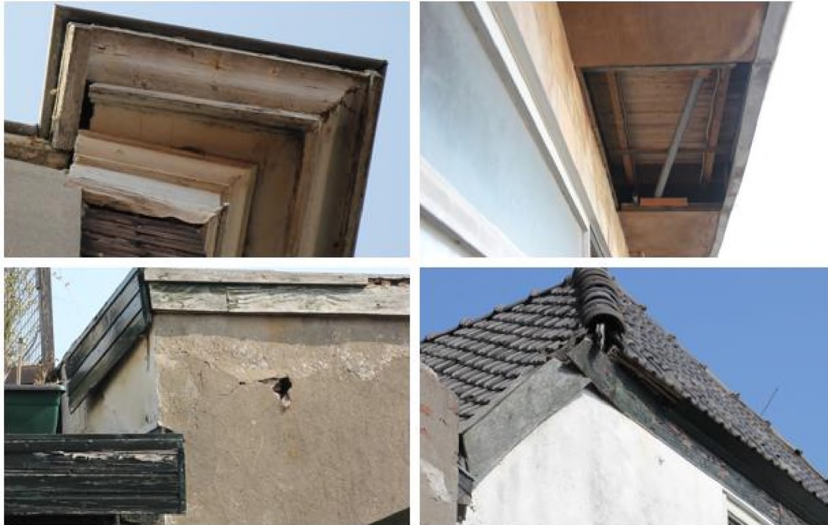
Figuur 5.1. Geschikte kieren en gaten in de monumentale huizen 6 -10 en de aangrenzende aanbouw en schuren.
