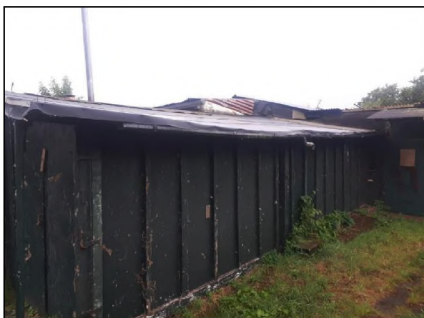
Foto 5: Schuren gezien in noordwestelijke richting
