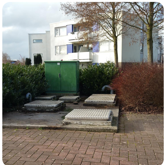
Foto: hoofdgemaal De Deel (Bodegraven)
