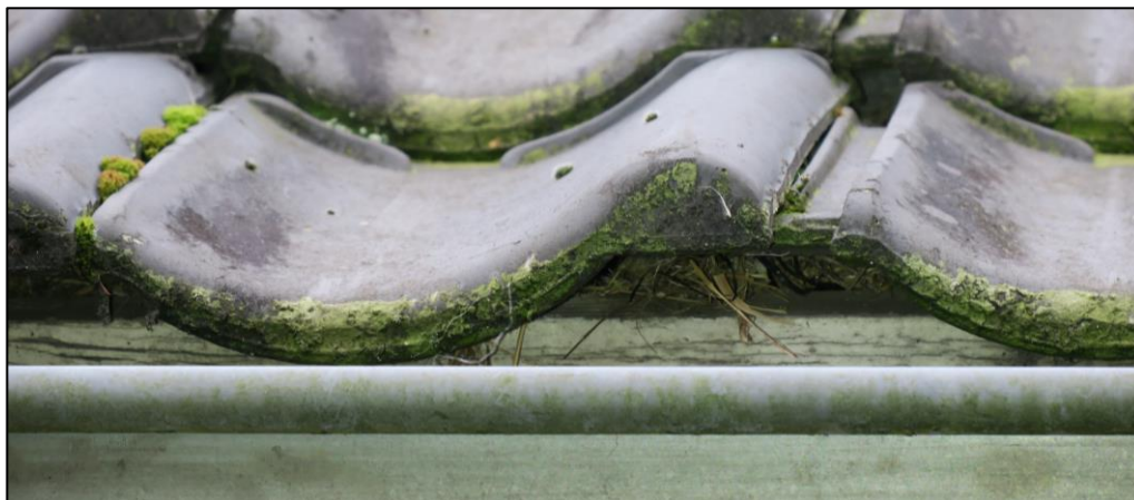
Figuur 5 Onder het dak van bijgebouw 2 is nestmateriaal aanwezig.
