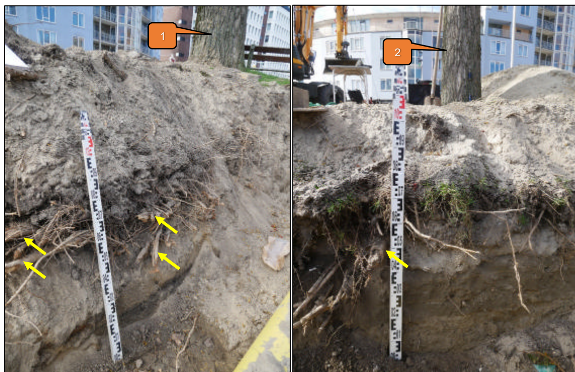
Foto 6 en 7: Links een beeld van wortelschade bij boom 1. Rechts een beeld van de wortelschade bij boom 2. Beschadigde stabiliteitswortels met een Ø >5 cm zijn met gele pijlen aangeduid.
