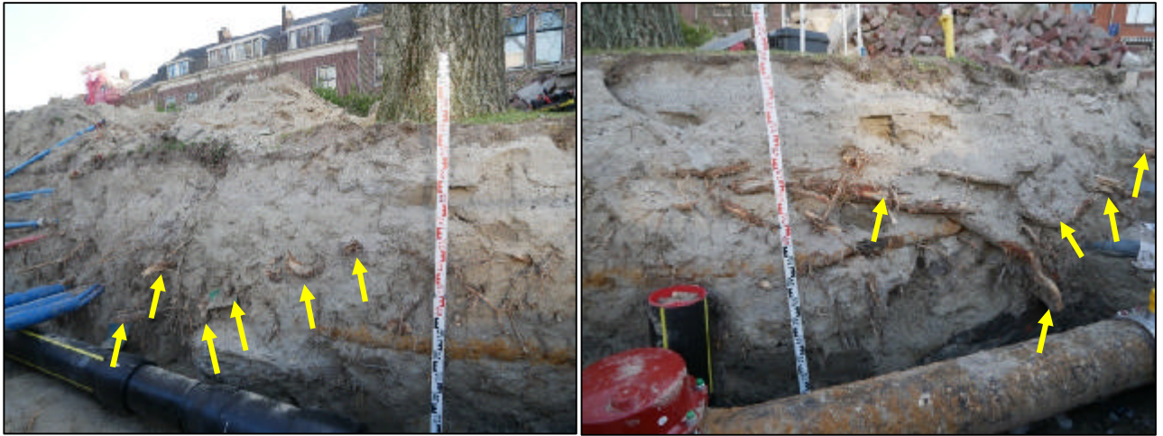
Foto 12 en 13: Links en rechts een beeld van de wortelschade bij boom 6. Beschadigde stabiliteitswortels met een \varnothing > 5 cm zijn met gele pijlen aangeduid.
