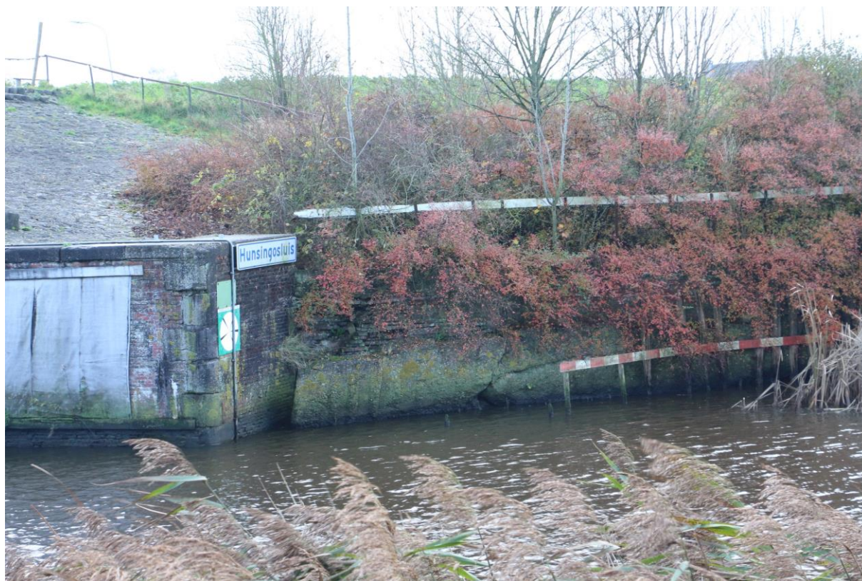
Figuur 155. De zeer bouwvallige kademuur aansluitend op de zuidwestelijke vleugelmuur.
