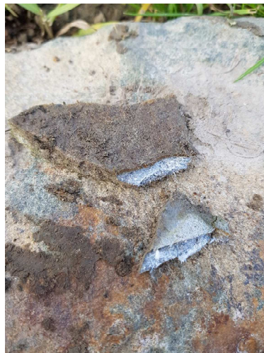
Foto 92: Situering toekomstig fietspad Zoutkamp-Electra (asbestverdacht materiaal aangetroffen op maaiveld)
