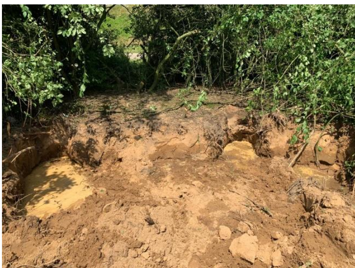
Figuur 4 2 dassenpijpen waar water uitstroomt (bron: foto dijkbeheerder)
