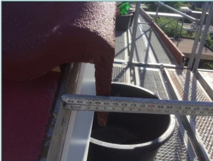
Figuur 6: afstand van 3 cm tussen boeibord en gevelpan. Hierdoor ontstaat een invliegopening en toegang tot de ruimte onder de dakpannen voor vleermuizen en gierzwaluw.
