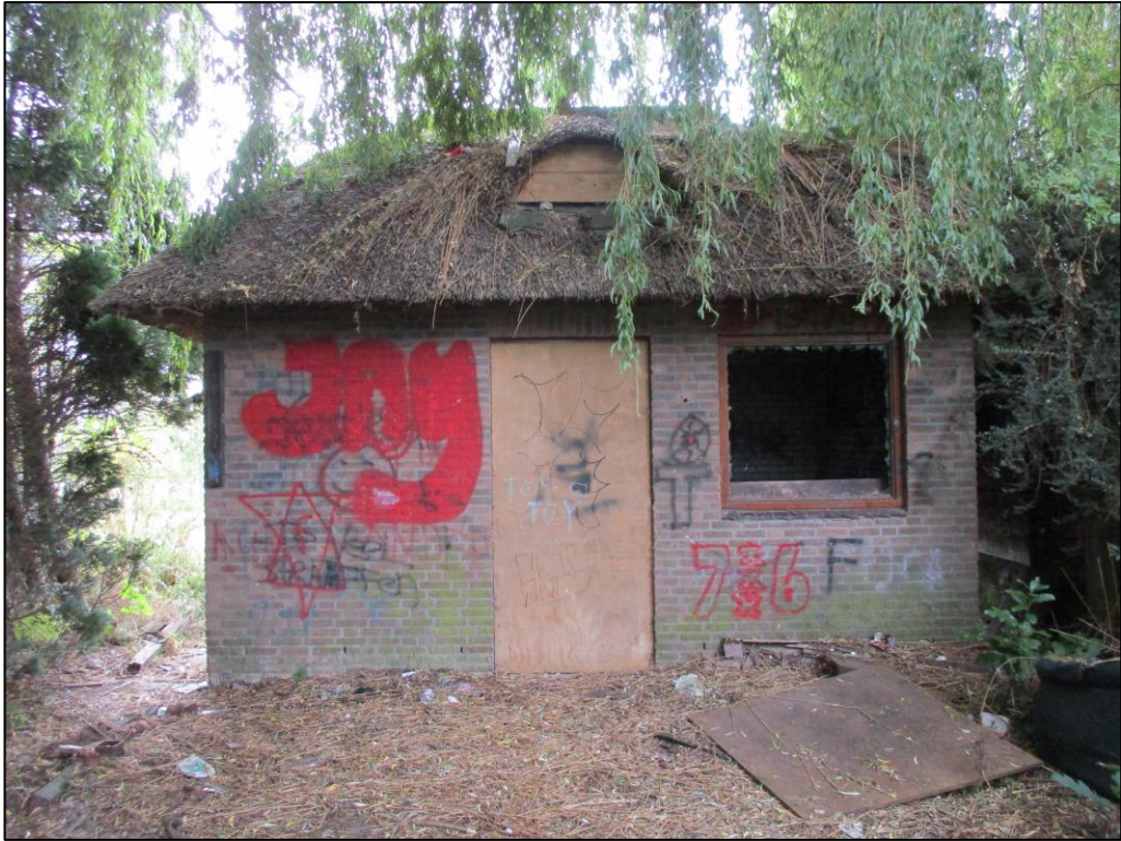
Figuur 3 Het elektriciteitshuis.
