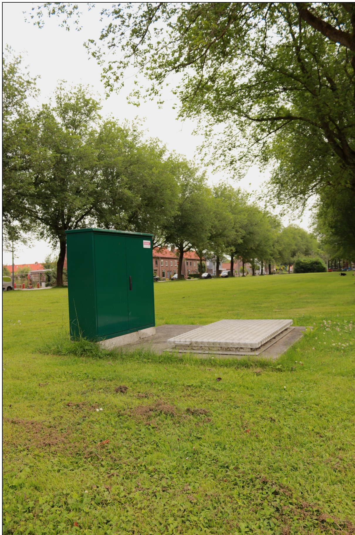
Rioolgemaal in Wieringerwerf
