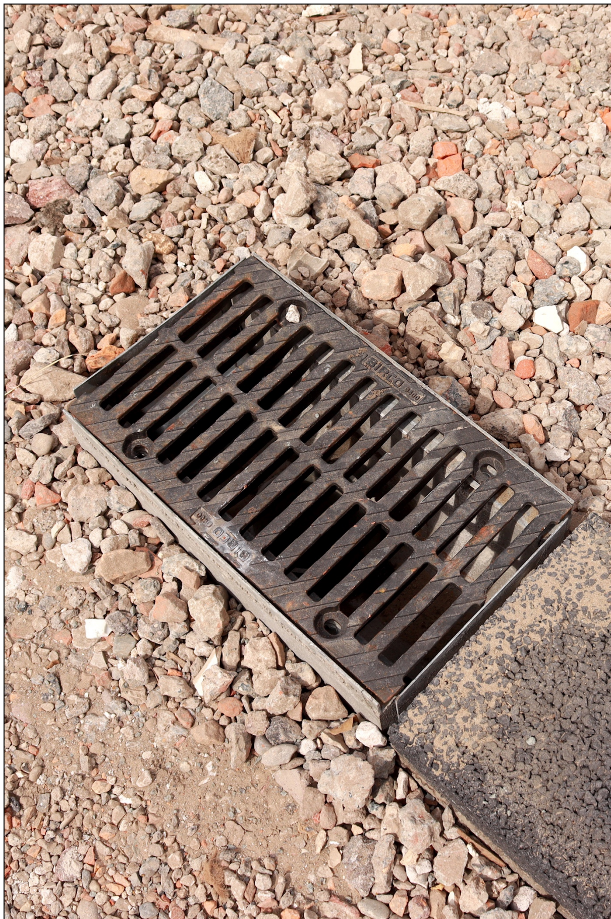
Straatkolk en permeablok
