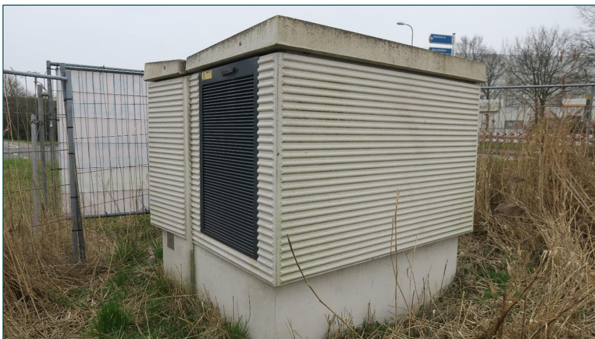
Figuur 4 Op de planlocatie staat een elektriciteitskast. Binnen de beoogde ruimtelijke ingreep blijft deze behouden.
