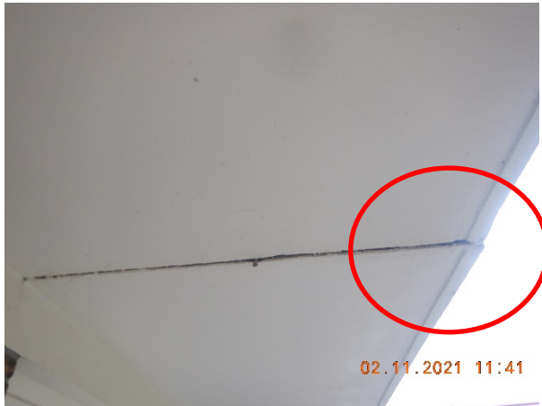
Figuur 5.10: Doorbuiging uitkragende galerijvloer ten opzichte van ingeklemde galerijvloer.
