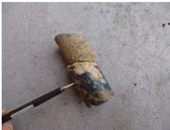
Figuur 5.2: Uitgeleverde kern beoordelen op scheuren en corrosie wapening.
