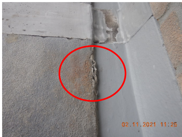
Figuur 5.13: Coating beschadigd.
