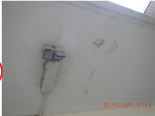
Figuur 5.11: Coating aan onderzijde bladdert af.
