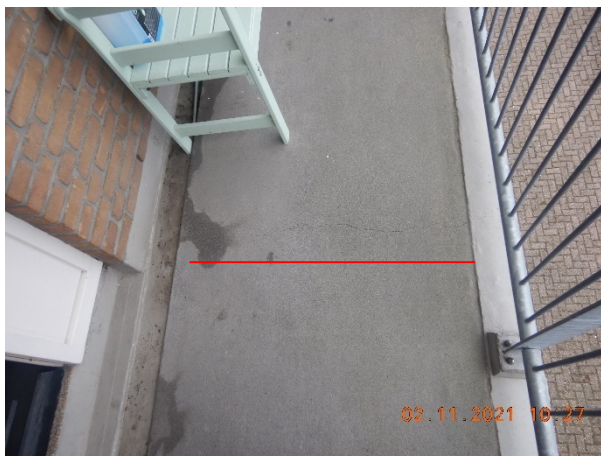
Figuur 5.12: Scheuren haaks op gevelrichting.
