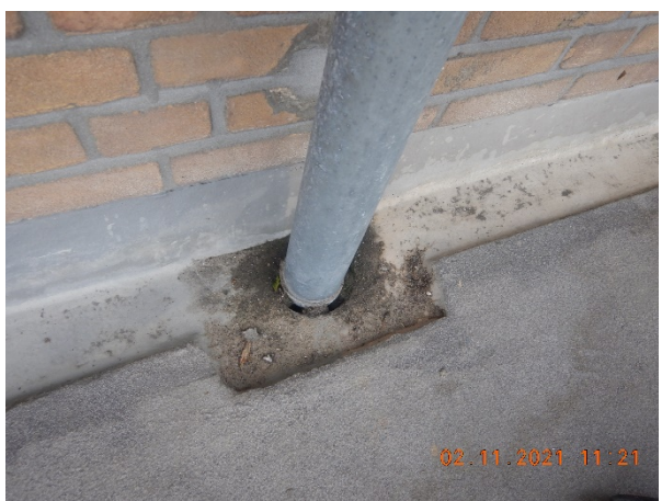
Figuur 5.14: Hemelwaterafvoeren incidenteel vervuild.
