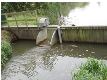
Figuur 1: Voorbeeld automatische klepstuw (bron: JoostdeVree.NL)
