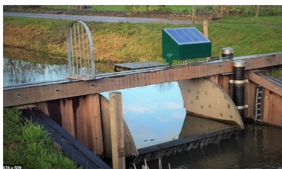
Figuur 2: Voorbeeld automatische stuw met zonnepanelen (bron: TMC)
