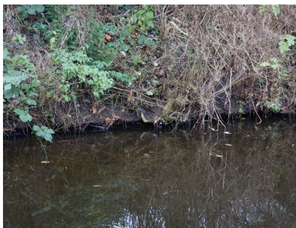
Figuur 2.6: Geërodeerd talud ter hoogte van de waterlijn
