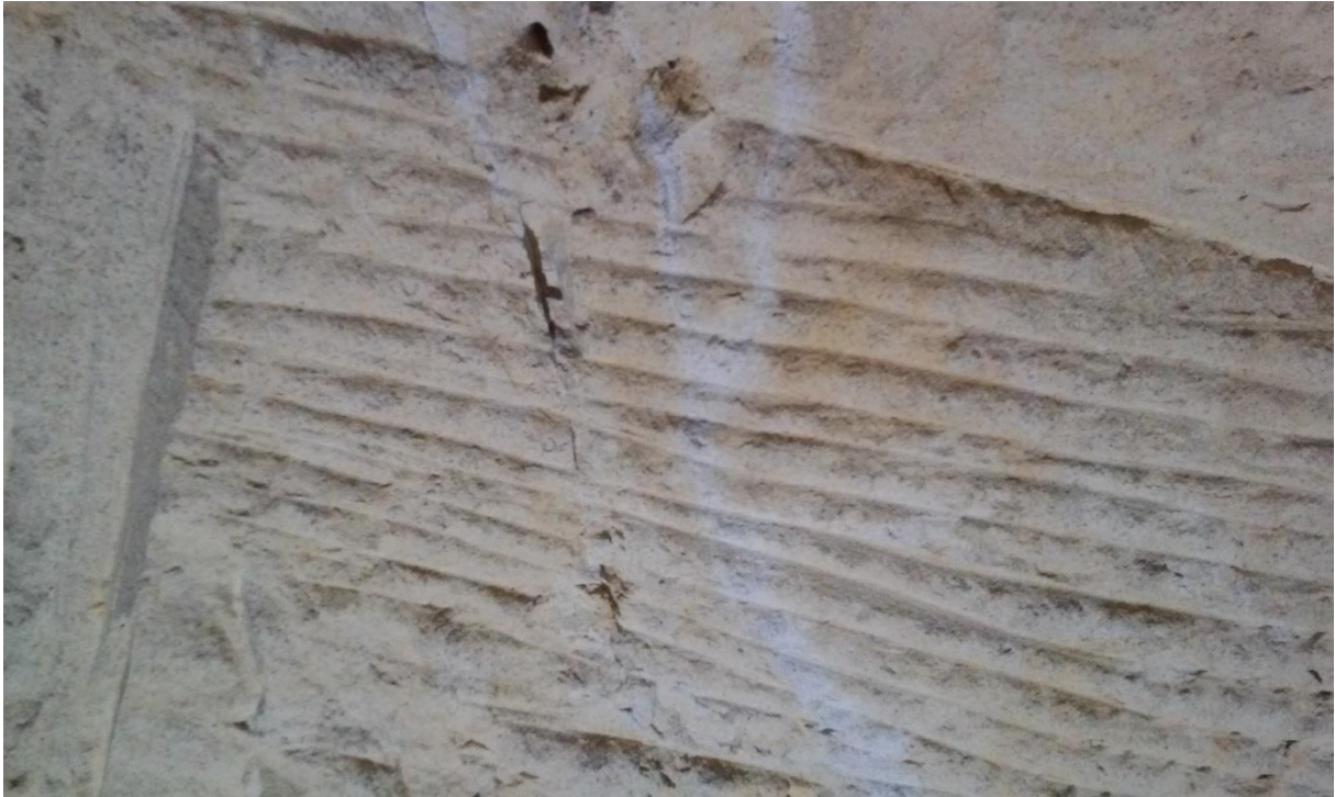
Locatie 3, de natuurlijke breuk die zorgt voor een verzwakking in het dak, parallel aan deze breuk loopt een haarscheur veroorzaakt door zetting.
