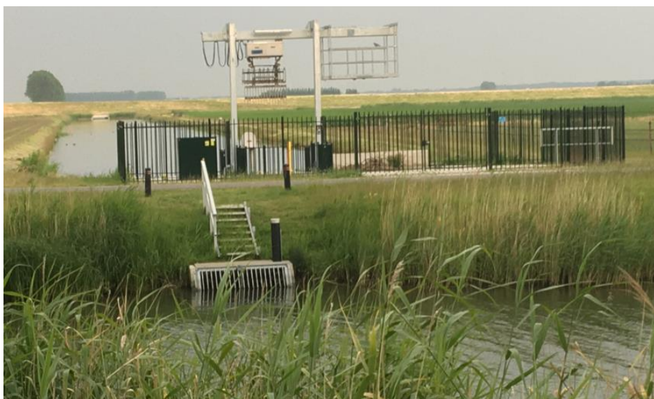
Figuur 10: Op de voorgrond de by-pass leiding bij de sifon Dirksland.
