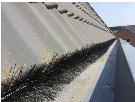
Voorbeeld van een weringsborstel in de goot, bedoeld om nestelende huismussen te weren.
