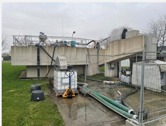
Figuur 19 Pilot Fijnzeefinstallatie op AWZI Zeewolde
