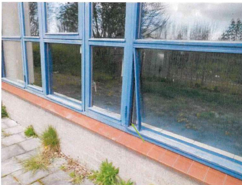
Foto 1 Niet asbesthoudende bruine kit achter glaslat (M01)
