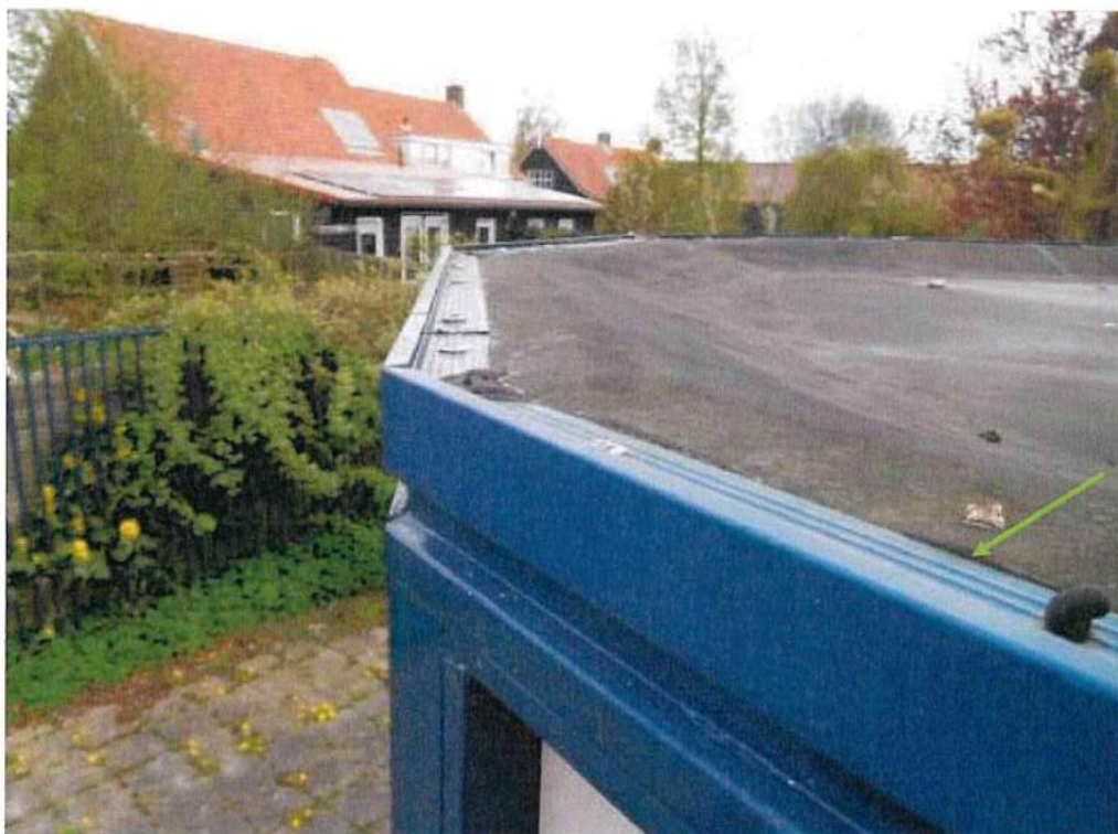
Foto 2 Niet asbesthoudende kit dakrand (M02)
