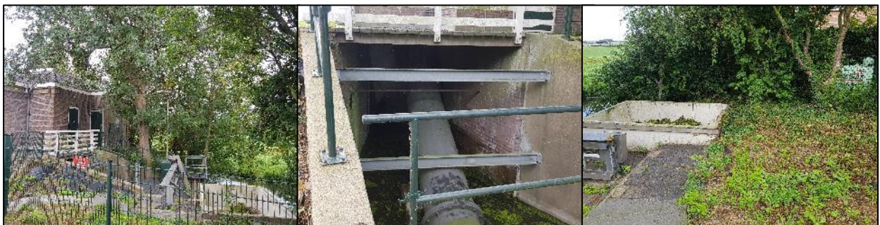
Afbeelding 3: Inlaat en gebouw omgeven door hekwerk (links), inlaat aan noordzijde, met persleiding, omgeven door betonnen wand (midden) en de kroosbak op het talud van de inlaat van het gemaal (rechts).
