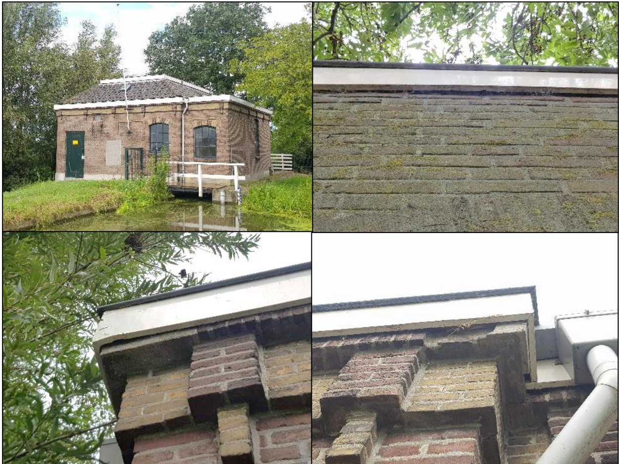
Afbeelding 2: Gebouw van gemaal met dakpannen en daklijsten (linksboven), ruimte tussen de gevel en de daklijst (rechtsboven), ruimte door schade aan daklijst (linksonder) en ruimte door schade aan gevel (rechtsonder).
