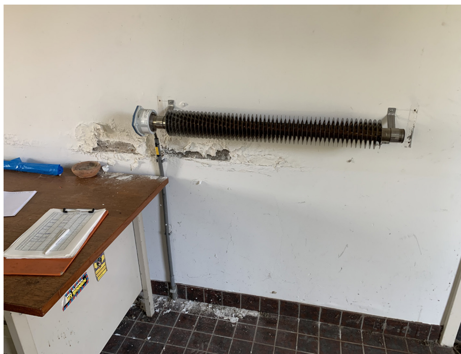
(afb. 68) ribbuiskachel in de machinekamer (foto's TAK architecten, 01 december 2020)
