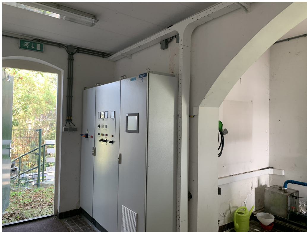
(afb. 64) schakelkasten in de machinekamer (foto's TAK architecten, 01 december 2020)
