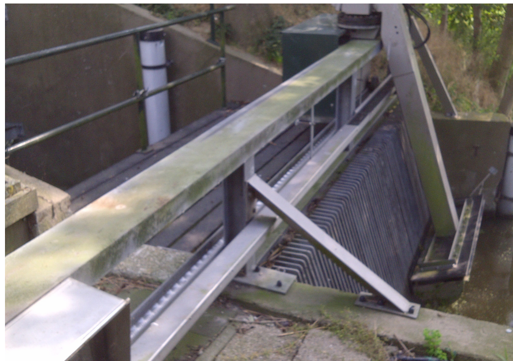
(afb. 59) gemaal aan de inlaatzijde met krooshekreiniger (foto TAK architecten, september 2020)
