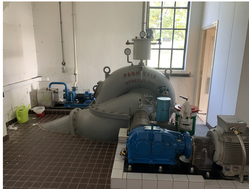
(afb. 65) machinekamer met de elektromotor, de Pannevis centrifugaalpomp uit 1919 en de vacuumpomp | foto: TAK architecten (01 december 2020)
