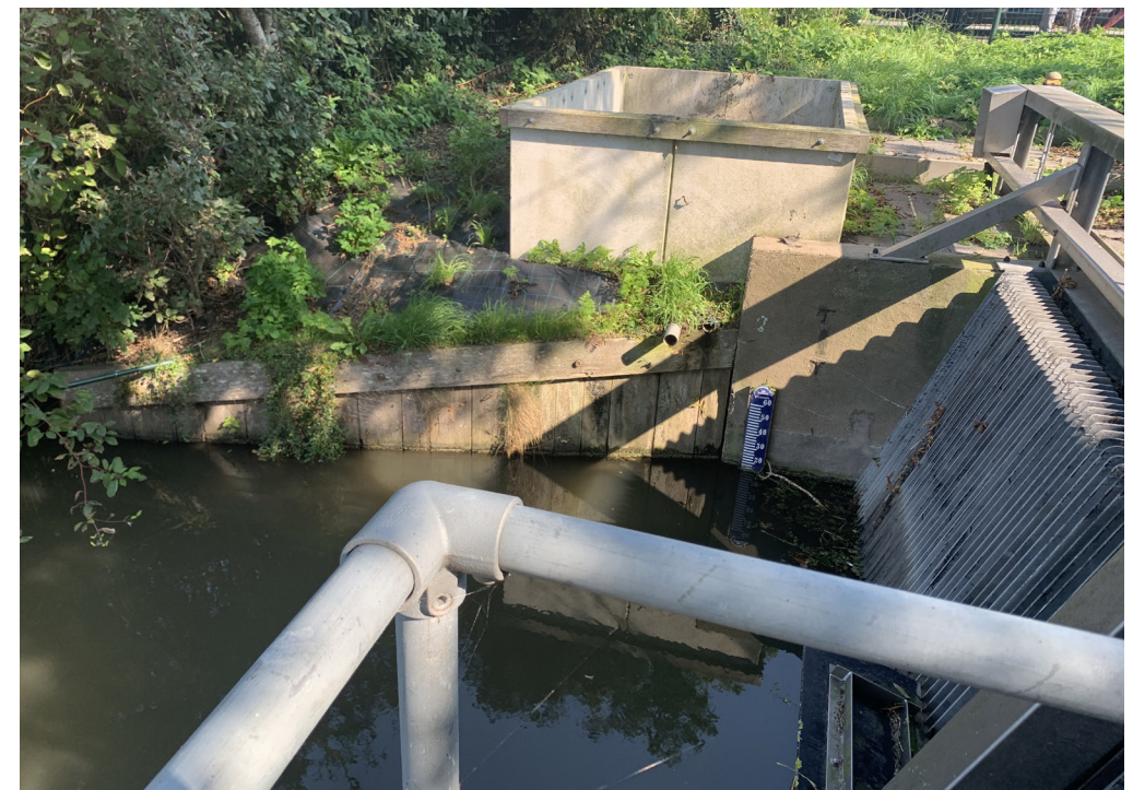
(afb. 62) kroosbak en krooshekreiniger(foto TAK architecten, september 2020)
