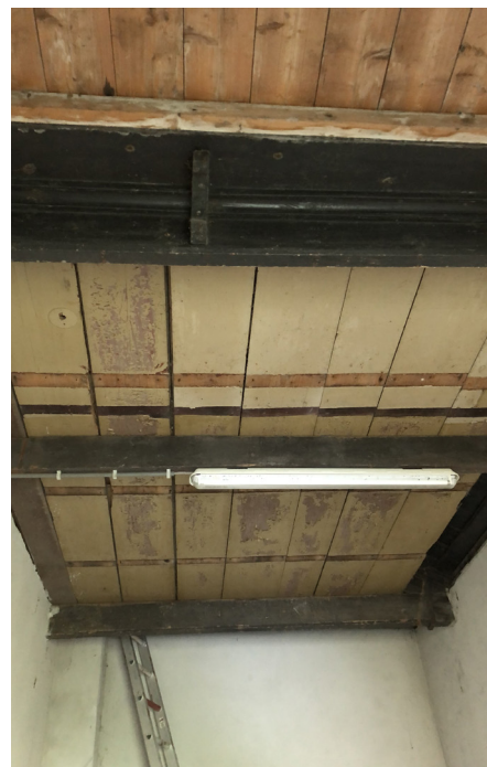
(afb. 76) vrm. ketelruimte met houten plafond | foto: TAK architecten (01 december 2020)
