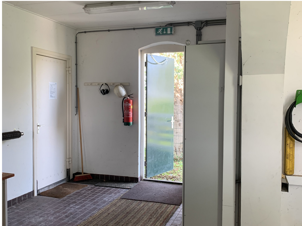
(afb. 71) machinekamer (foto's TAK architecten, 01 december 2020)
