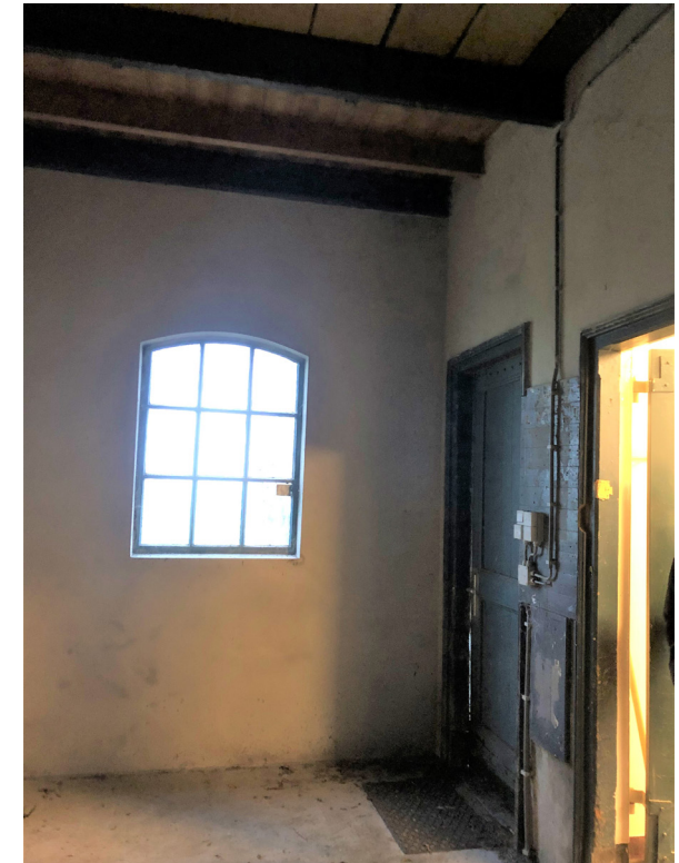
(afb. 77) vrm. ketelruimte (foto TAK architecten, 01 december 2020)
