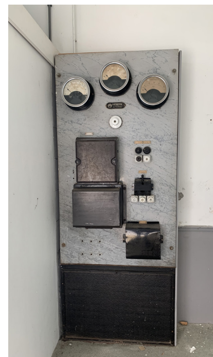
(afb. 70) schakelbord uit 198-1920 (foto's TAK architecten, 01 december 2020)
