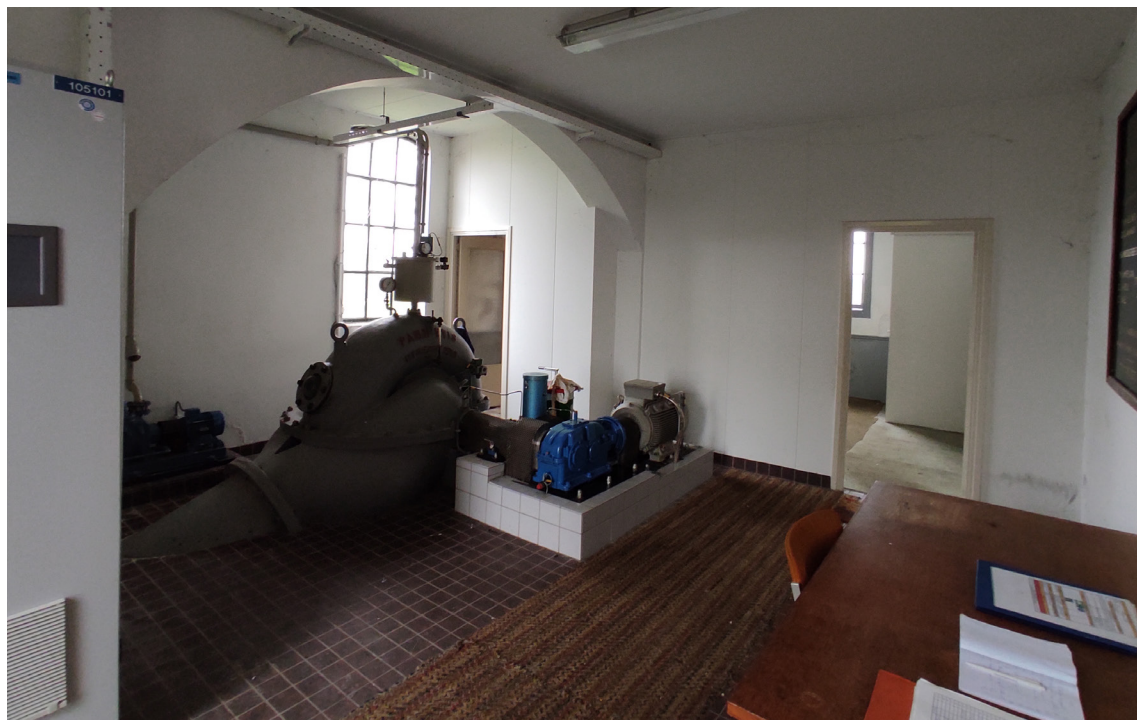
(afb. 29) de huidige situatie van het gemaalgebouw met de pannevis centrifugaalpomp uit 1919 en de indeling en installaties van na 1985 / foto: TAK architecten (2021)
