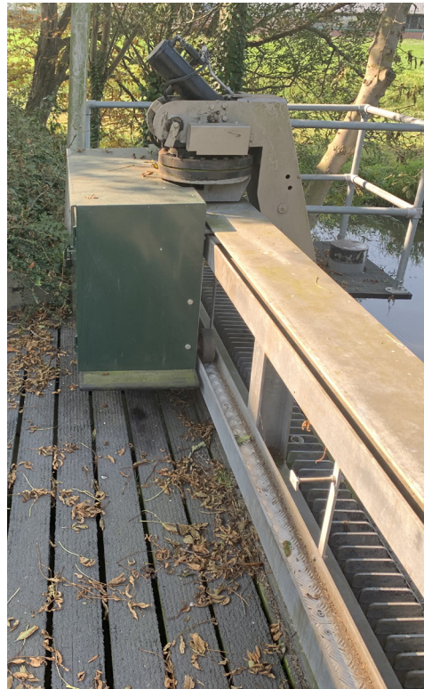
(afb. 60) kroosbrug en krooshekreiniger (foto TAK architecten, september 2020)
