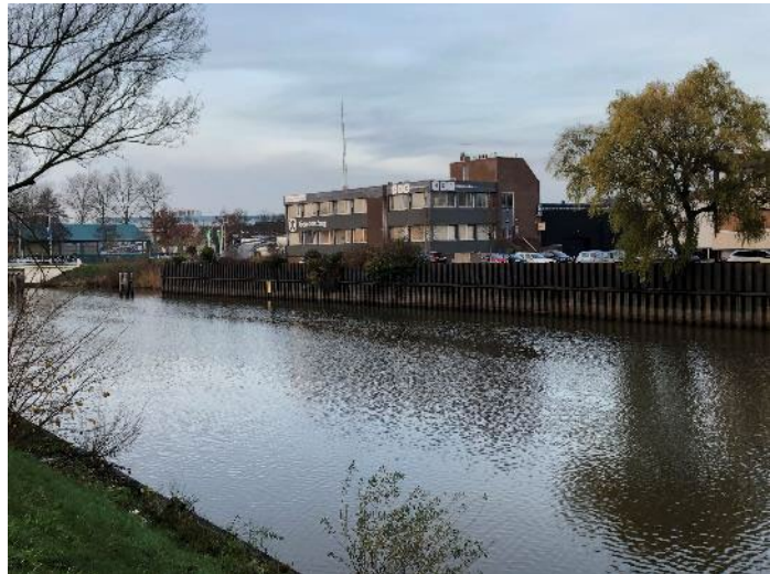
Foto 7.1: Huidige damwand A28 Zwarte Water
