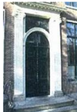
Het gebruik van kunststof is niet toegestaan
