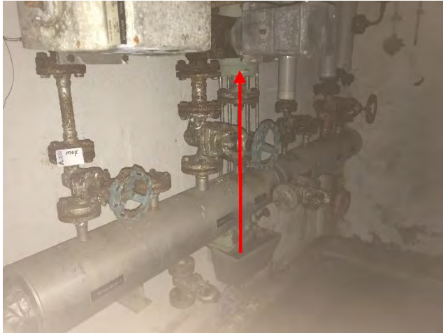
Foto 5 | Foto voor bron leidingisolatie kruipruimte 6, gang, onderstation
