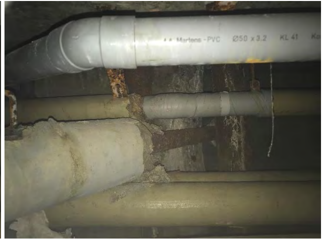
Foto 4 | Foto voor bron leidingisolatie kruipruimte 6, gang, onderstation
