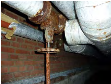
foto 9, aanzicht leidingen niet verdachte isolatie
