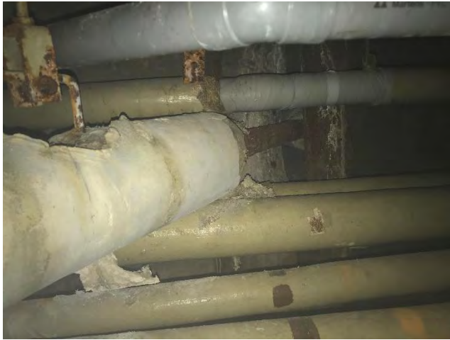
Foto 3 | Foto voor bron leidingisolatie kruipruimte 6, gang, onderstation
