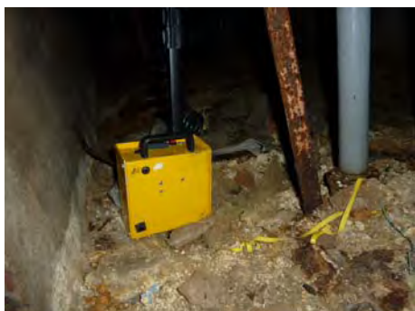
foto 5, opstelplaats luchtpomp LE 04
