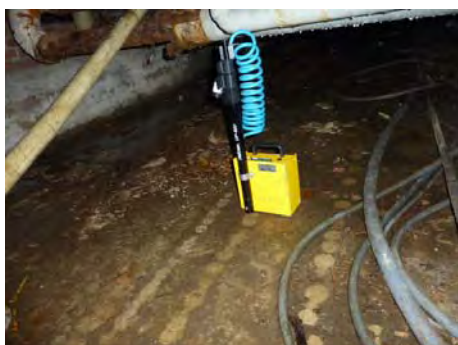
foto 1, opstelplaats luchtpomp LE 01
