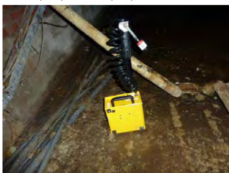
foto 3, opstelplaats luchtpomp LE 02
