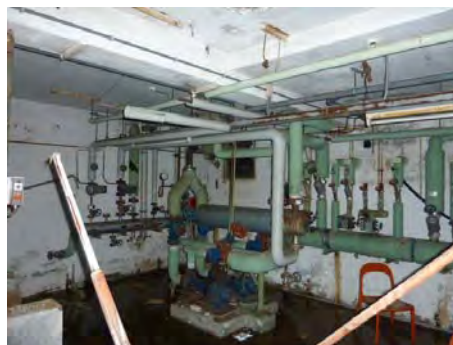
foto 18, onderstation met toegang kruipruimte
