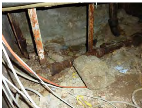
foto 14, zwaar beschadigde leidingisolatie Amosiet
