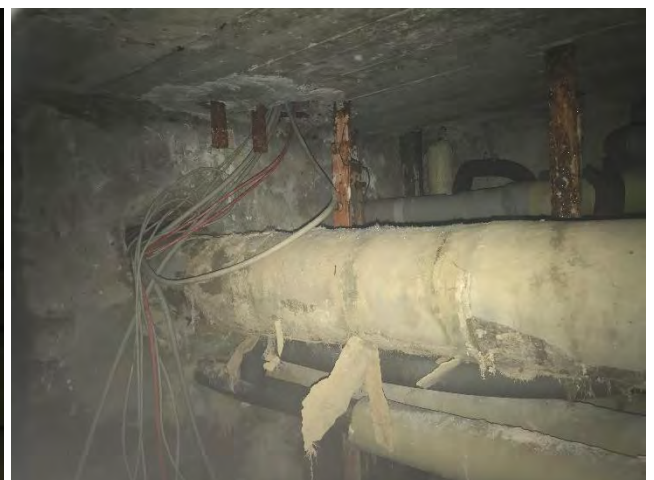
Foto 2 | Foto voor bron leidingisolatie kruipruimte 6, gang, onderstation
