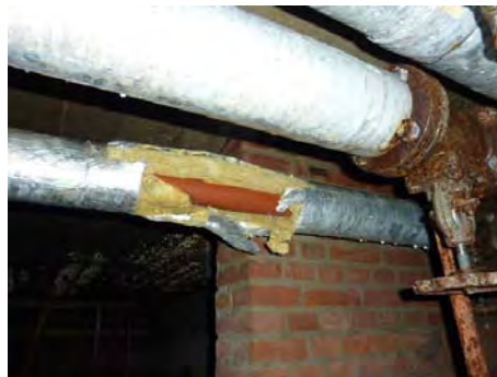
foto 10, leidingen met niet verdachte isolatie
