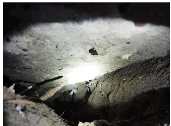
Afbeelding 6 foto vanuit een pijp, waar te zien is dat de onderkant van de vloer van de stal ongewapende beton deels in de lucht hangt
