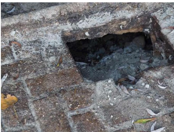
Afbeelding 5 detail verzakkingen in het straatwerk naast de stallen
