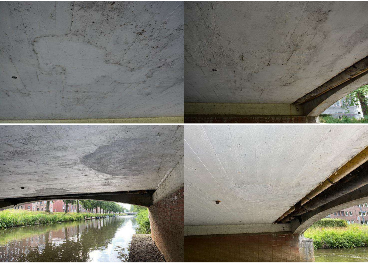
Oude betonreparaties onderzijde
