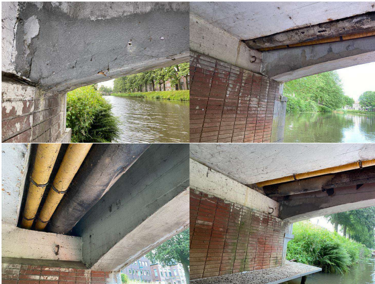
Oude reparatie in boogelement en nieuwe dekkingsschades
