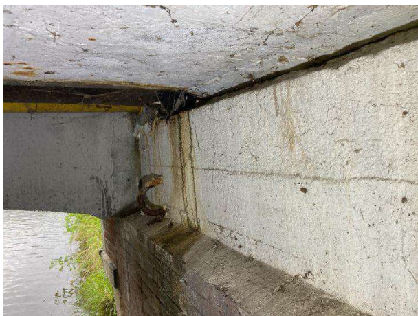
Leksporen ter plaatse van leidingdoorvoeren
