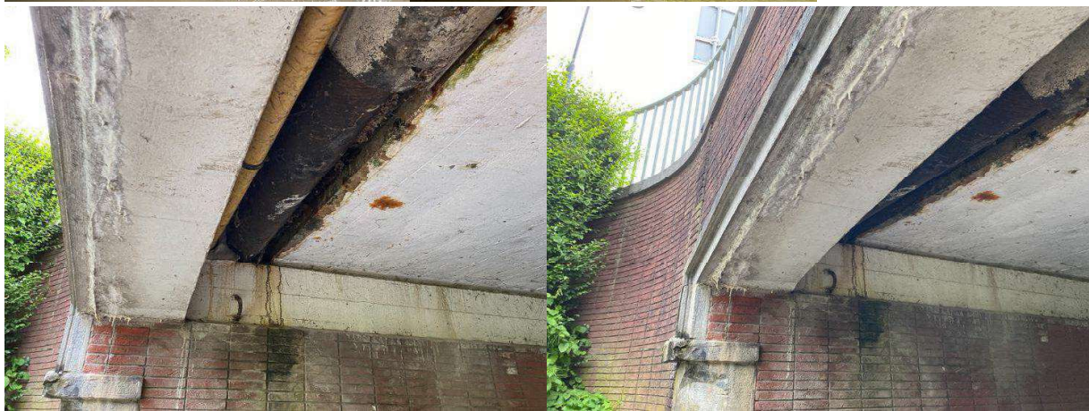
Oude reparatie in boogelement en leksporen aan buitenzijde boog
