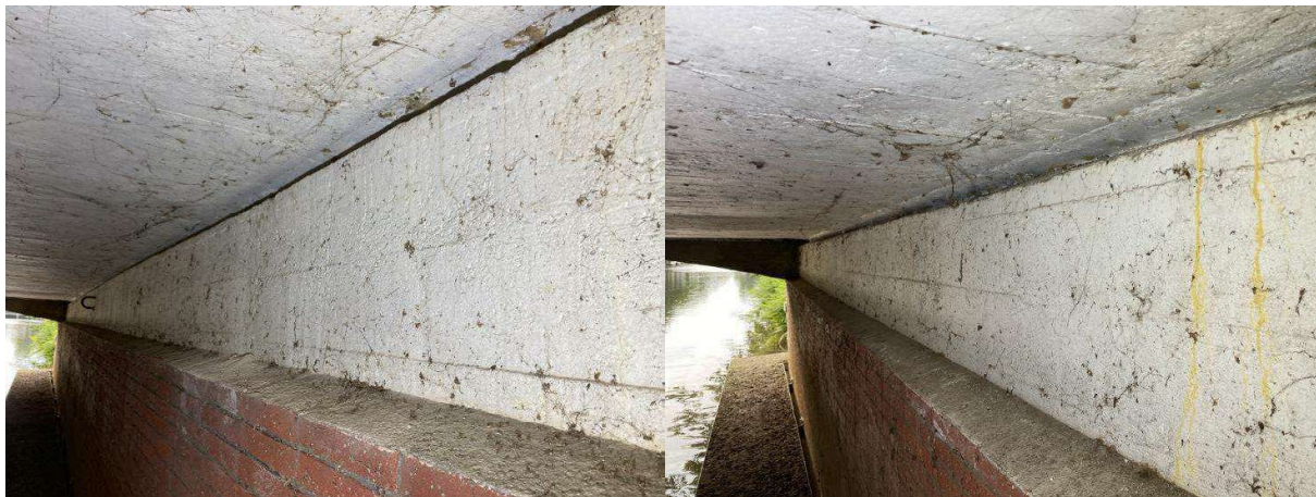
Landhoofden zonder schade of oude reparaties
