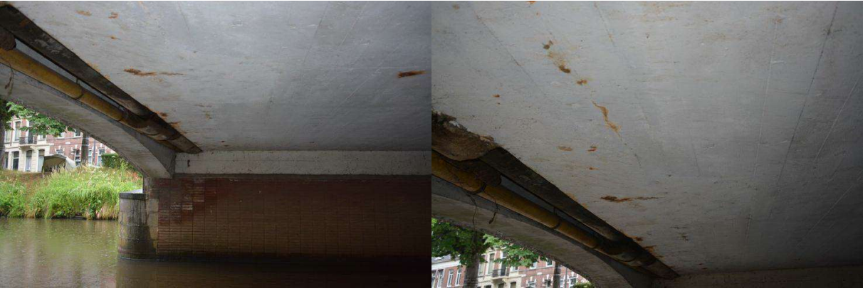
Scheurvorming met roestuitbloeding, en idem detail
