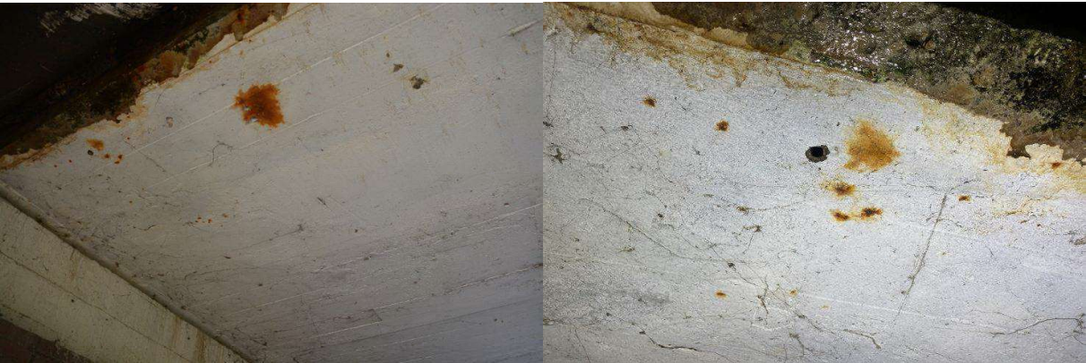
Roestvlekken in onderzijde dek
