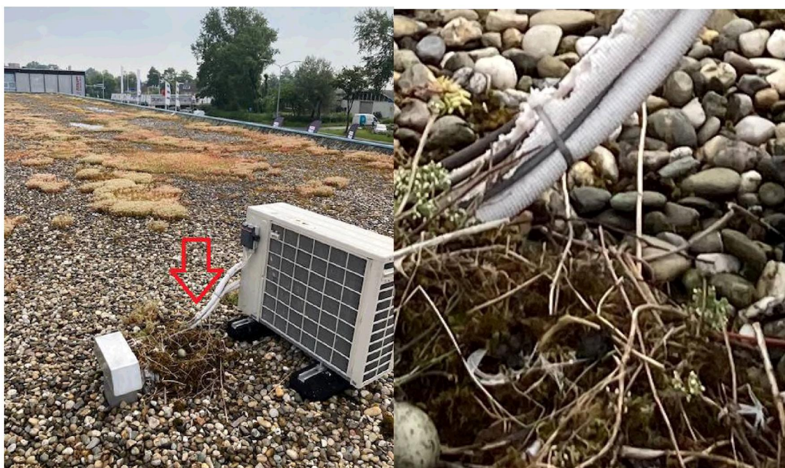
Figuur 23: Aangepikte isolatie rondom stroomkabels airco bedrijfspand Alkmaar (foto: [REDACTED])
