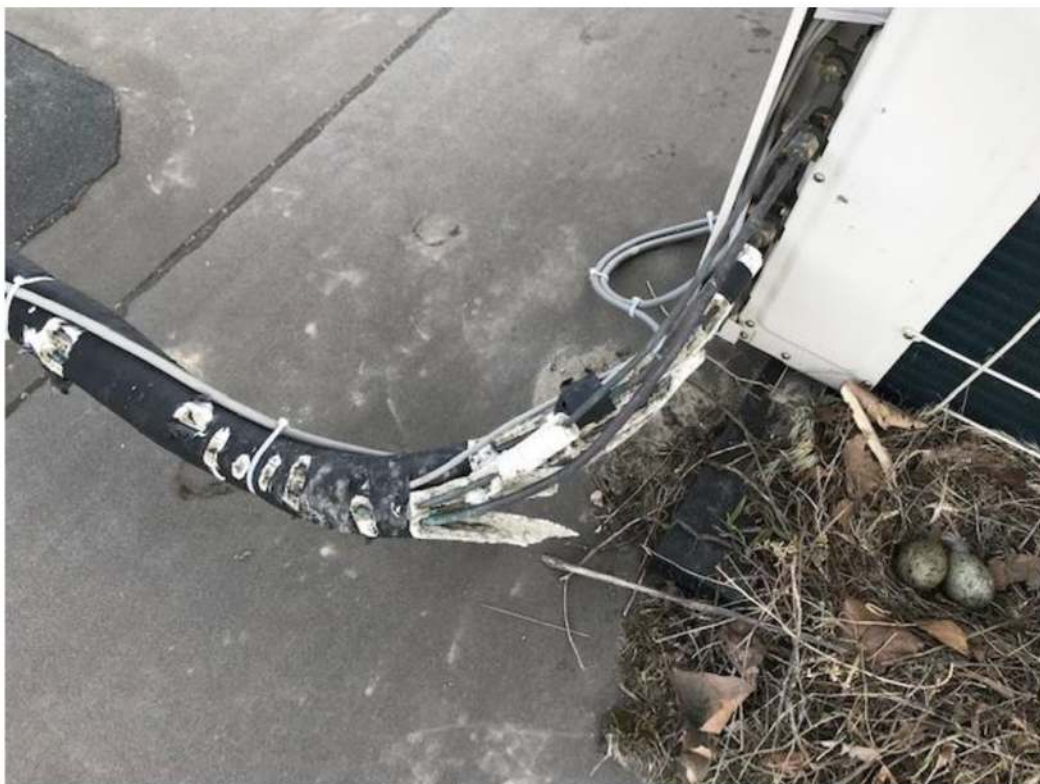
Afbeelding 9: Close-up van beschadigde bekabeling (brandgevaar/kortsluiting).
