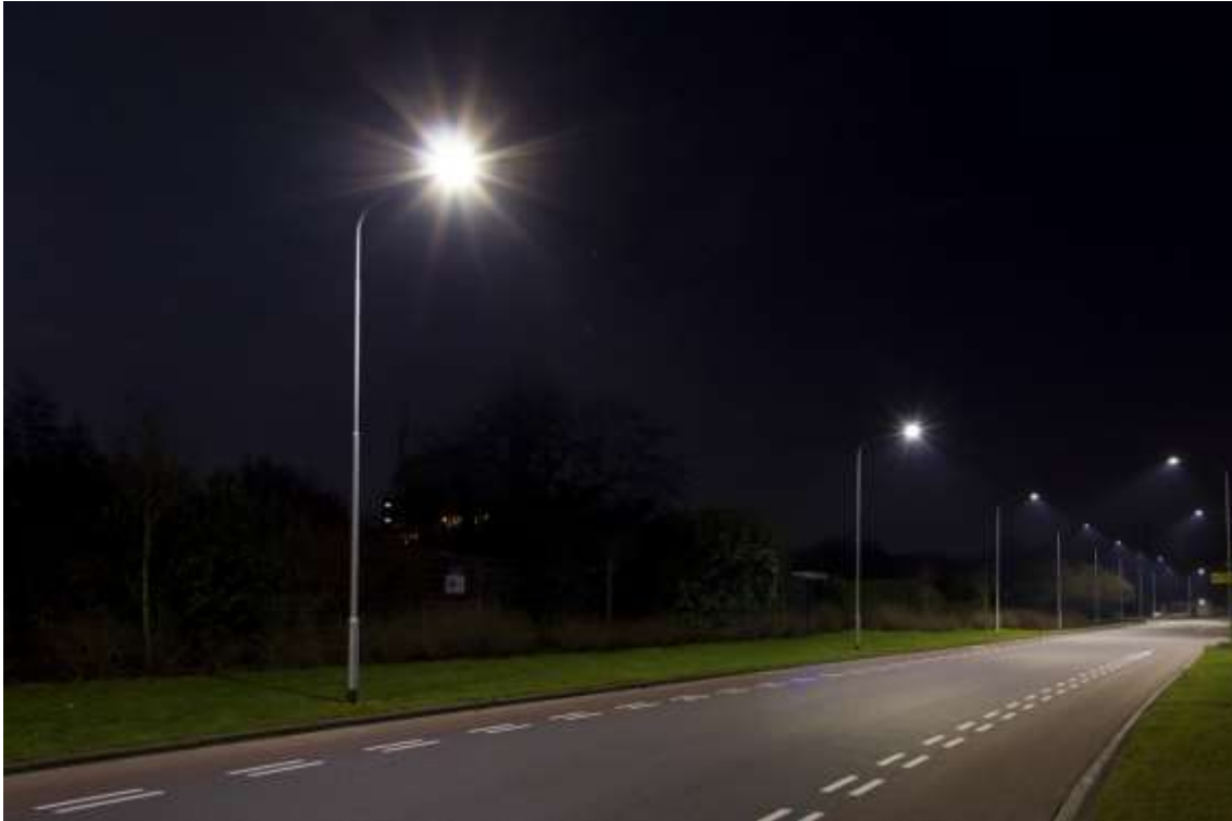
Foto: De Brinkenweg in Emmen is een doorgaande weg. Het licht is goed over de weg verdeeld zodat er geen zwarte vlekken zijn.
