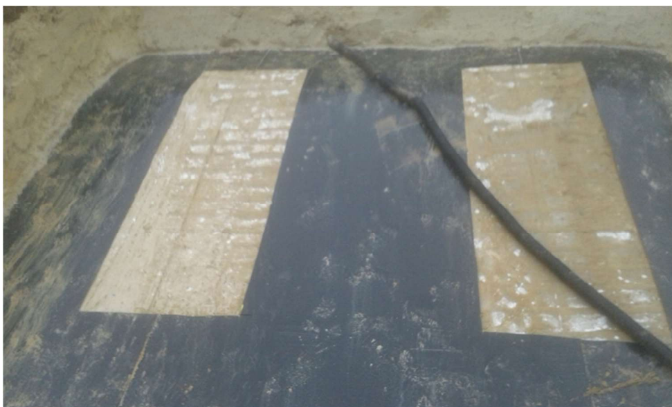
Fig. 4.7 Ondergrond onder folieconstructie bevat witte vlekken.; locatie 5
