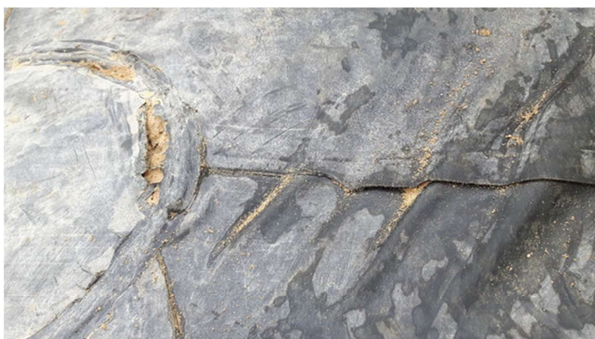
Fig. 4.5 Gevonden scheurvorming ter plaatse van reparaties; locatie 1.
