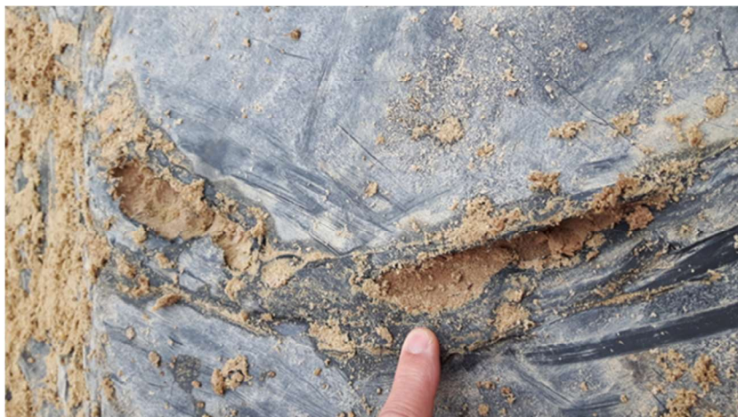
Fig. 4.4 Gevonden scheurvorming ter plaatse van reparaties; locatie 1
