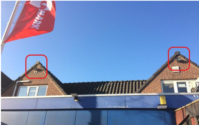
Fig. 10: wijkende nokpannen vlak boven een bouwlamp, vleermuizen zullen geen verblijfplaats kiezen met een verlichte toegang
