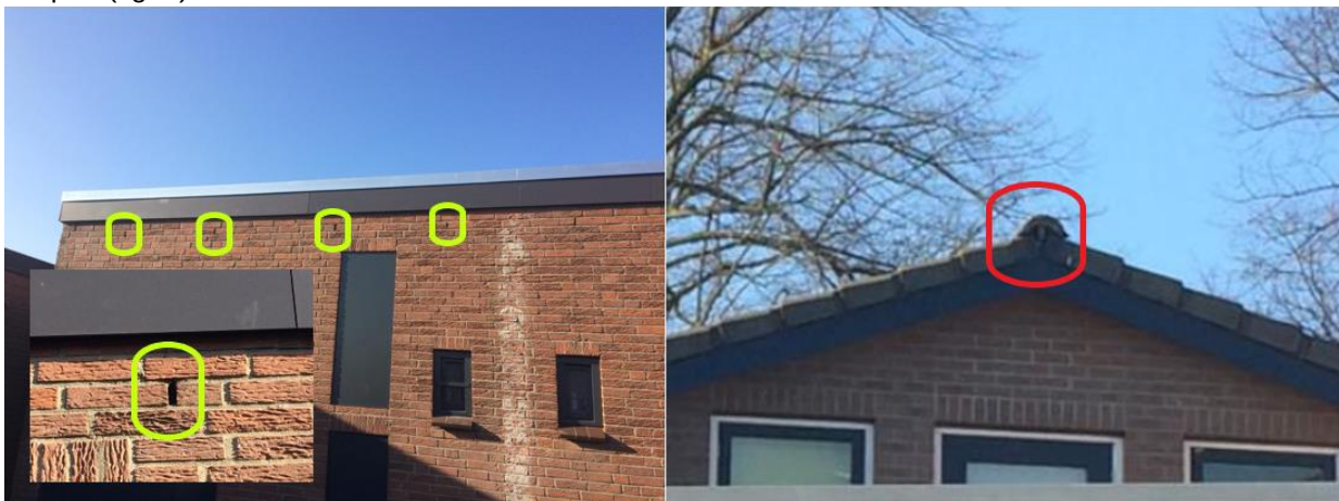
Fig. 8: groene kaders geven open stootvoegen weer, het rode kader de ontbrekende nokpan
