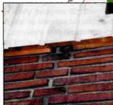
Figuur 11. Gevelbetimmering met ruimte voor vleermuizen (Bron: Checklistgroenbouwen).
