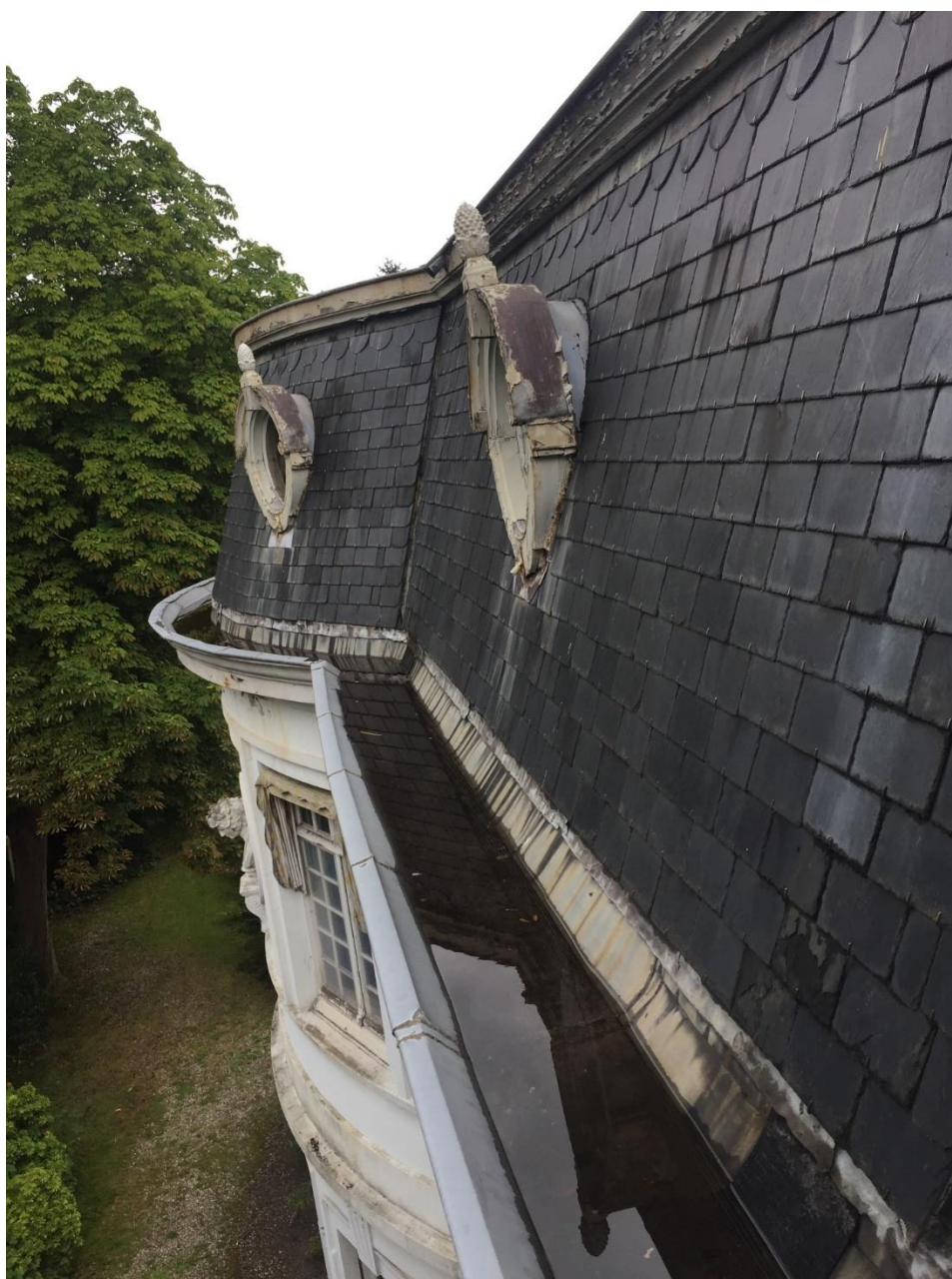
Foto 1 de technische staat van het schilder- en zinkwerk is matig
