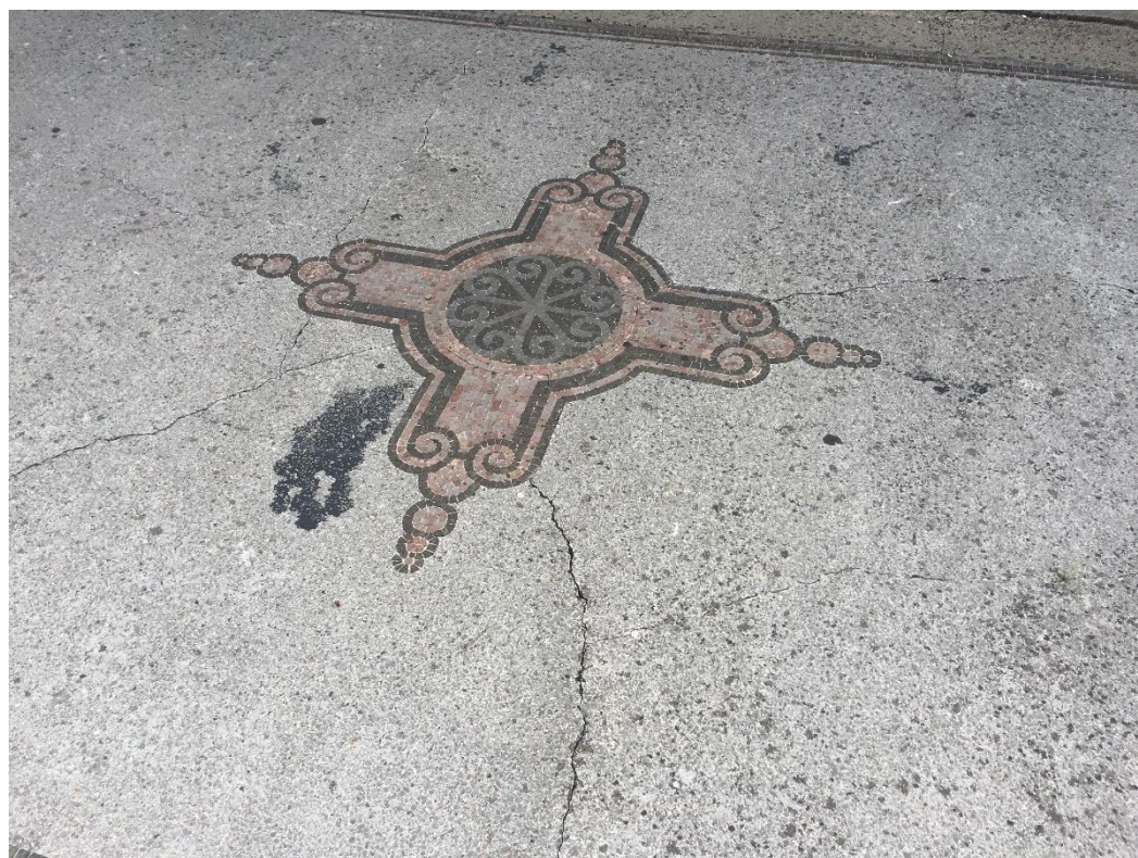
Foto 2 Gescheurde terrazzo dekplaat
