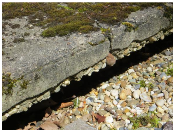
Afb. 1.20: Het kruisvormige bassin is vervaardigd uit beton, waarbij in de randafwerking een verschil in grof en fijn grind zichtbaar is. Hoewel nog compleet, zitten op diverse plekken in de bassinrand breuklijnen.
