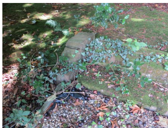
Afb. 1.23: Gebrekkige aansluiting van het grindpad (grind op worteldoek) met betonnen kantopsluiting op de gemetselde traptreden nabij de tuinmuur. Alle vier de trappen in de zijtuin zijn onderhevig aan verzakking.
