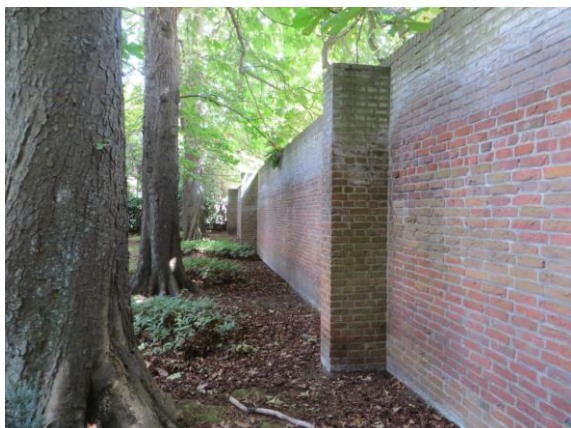
Afb. 1.36: De gemetselde tuinmuur is aan de zijde van villa voorzien van steunberen.
