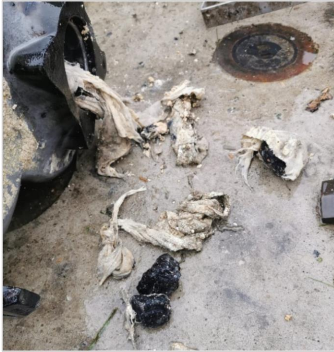
Figuur 3 verstopping pomp door doekjes en bouwafval
