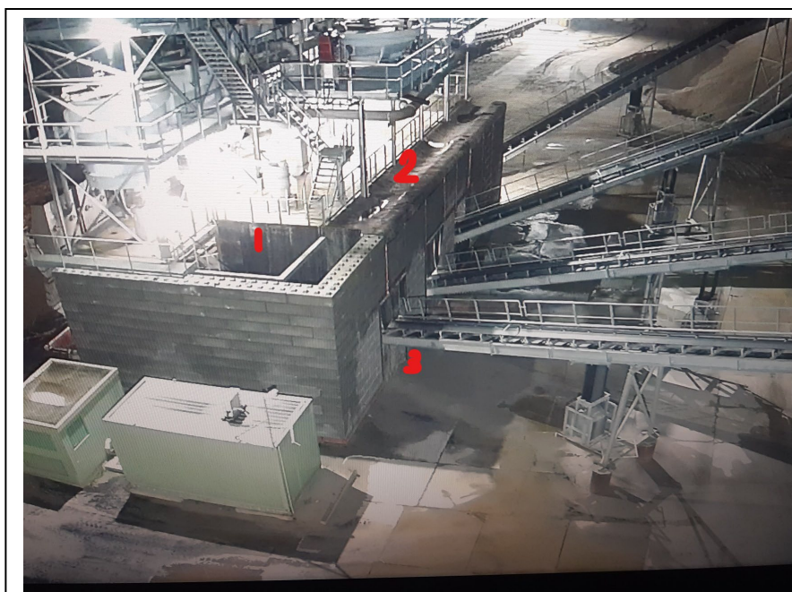
Figuur 2 met de wand en de rubberen matten om de klasseerinstallatie.
