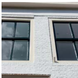
bouwnaad rechts boven entree 52 te zien aan verschil in metselwerk.
