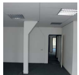
ingepakte standvinken op de verdieping van 54
