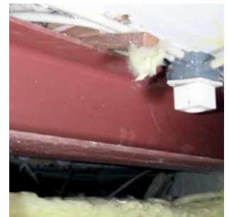
Stalen lateien ter plaatse van weggebroken muren.
