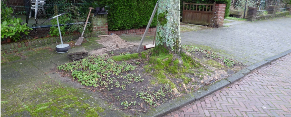
Afbeelding 13: Bestrating tegen tuinmuur is bol op gestraat. Boomspegel bevat veel oppervlakkige wortels die boven het maaiveld uitkomen
