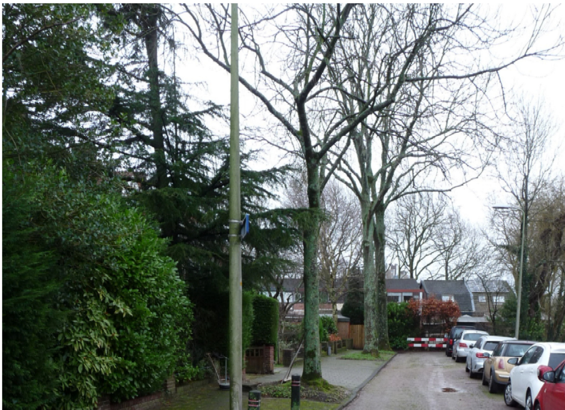
Afbeelding 6: Gewone essen aan de even zijde van de Prinses Beatrixlaan verkeren in een redelijke conditie
