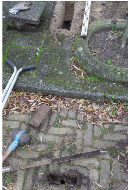
Afbeelding 10: Tot een meter in de parkeerstrook is bomenzand aangetroffen
