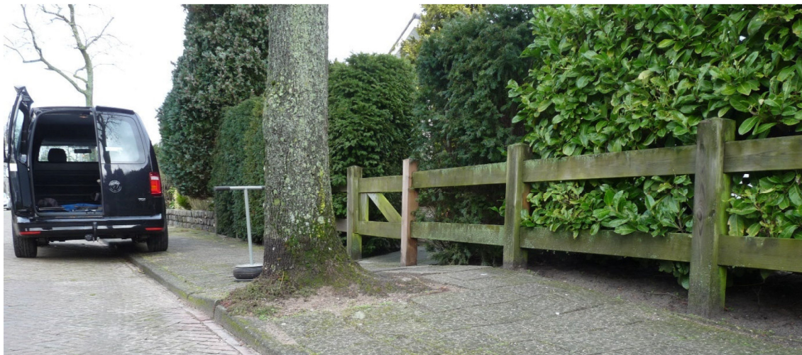
Afbeelding 21: Bestrating bij de eerste boom in de Prinses Margrietlaan ligt bol vanwege een dikkere stabiliteitswortel
