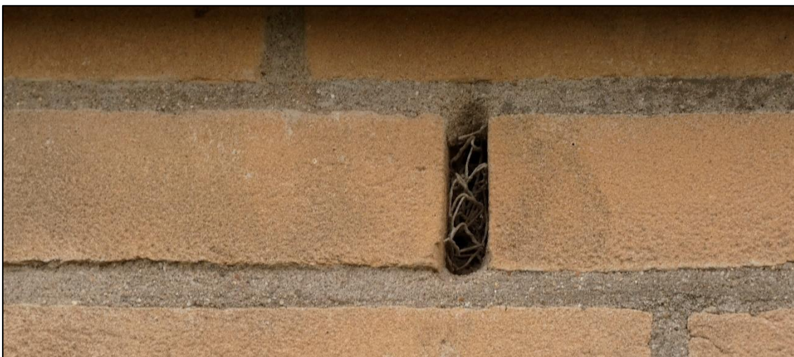
Figuur 9: De open stootvoegen zijn opgevuld waardoor vleermuizen geen toegang hebben tot de spouwmuur.
