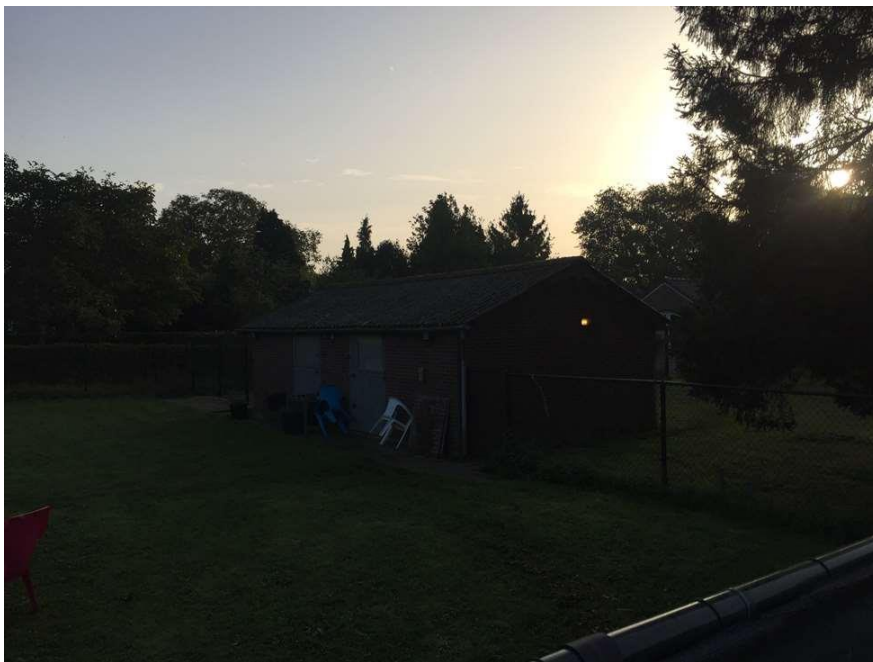
Afbeelding 10. Het schuurtje met mogelijk een asbestdak.
