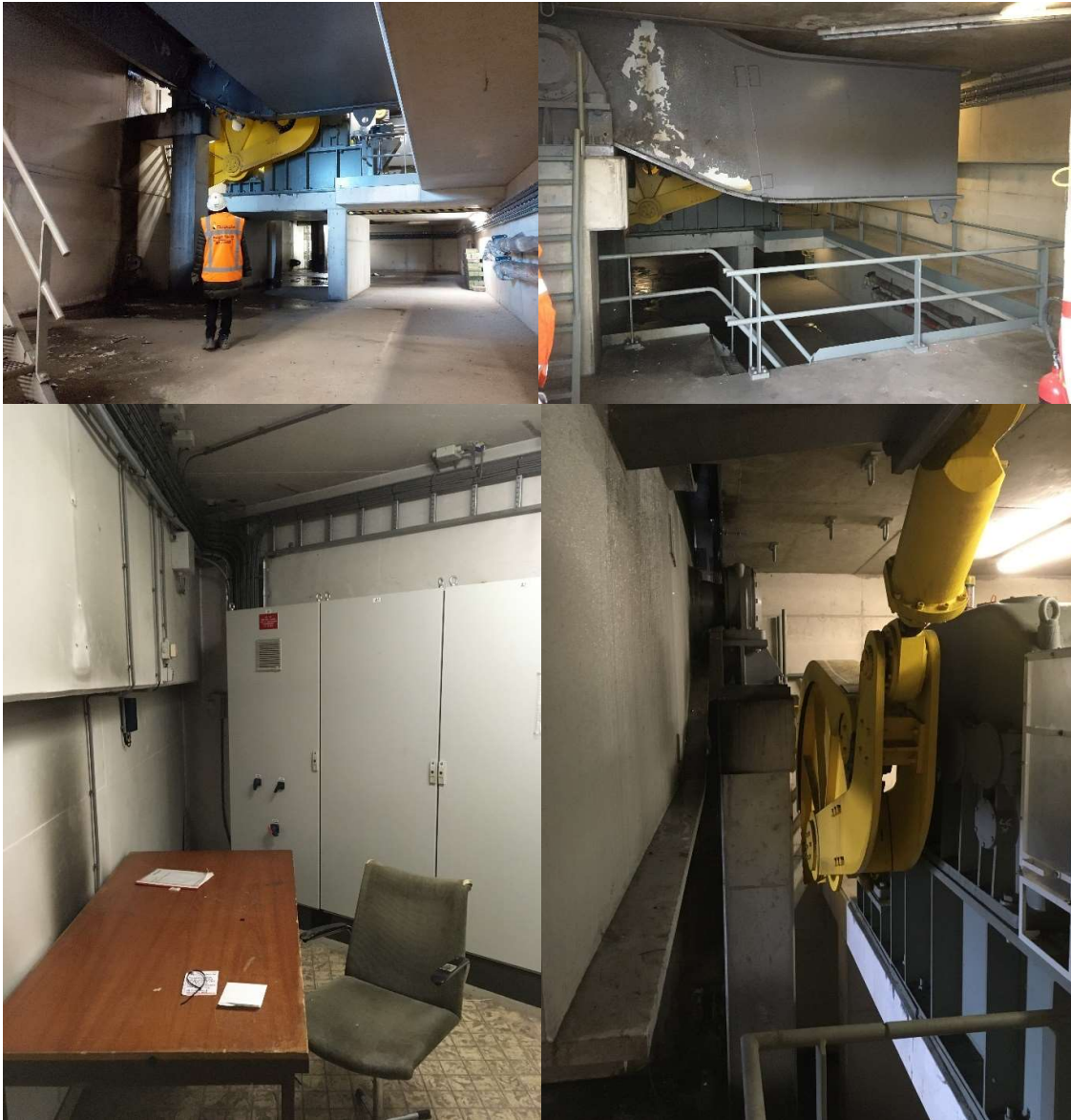
Figuur 18: foto's van de basculekelder, met de klok mee: begane grondvloer met ballastkist en panamawiel, ballastkist en verdiepingsvloer, panamawiel, technische ruimte.
