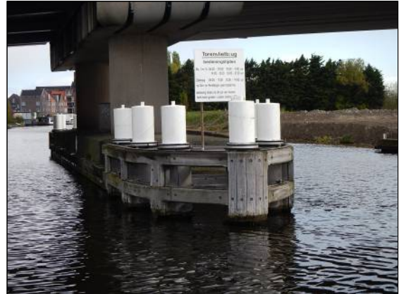
Remming- en geleidewerk; Remming- en geleidewerk, Algemeen
