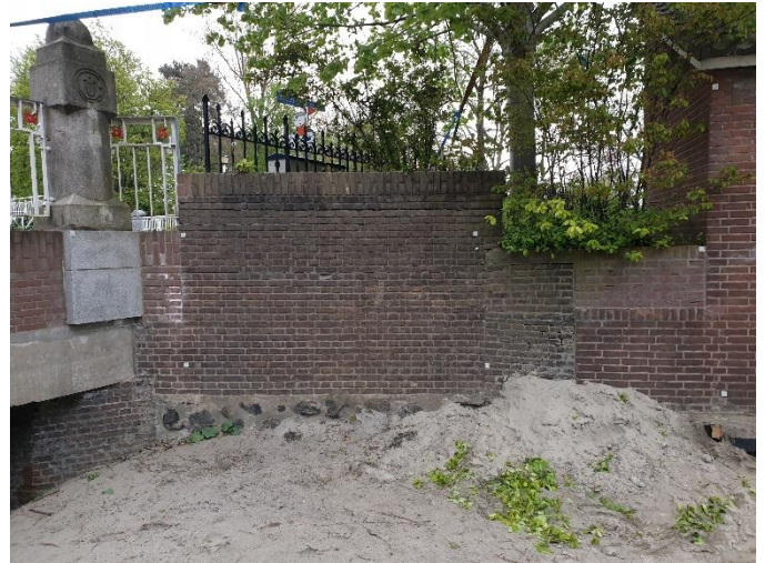
Figuur 1, bezweken vleugelwand
