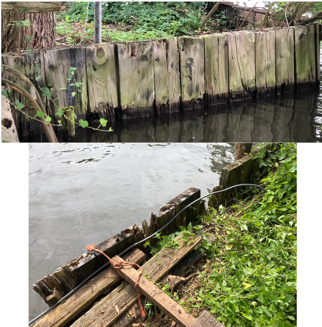
Oude situatie: gaten en ontbrekende gording
