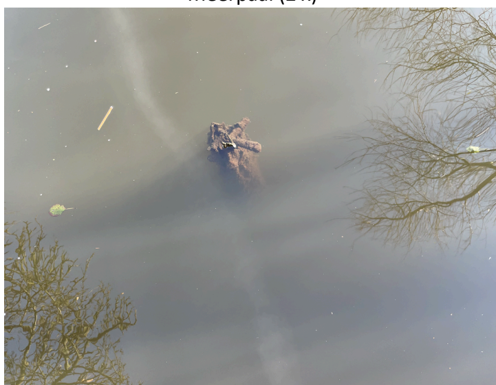
Aantal afgebroken/rotte palen (5/6)
