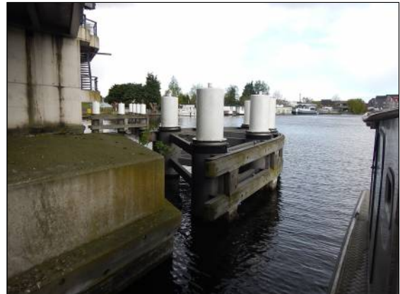
Remming- en geleidewerk
