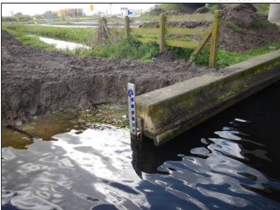
Kerende constructie; Peilschaal
