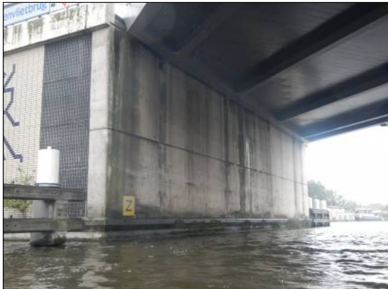
Basculekelder; Basculekelder, Algemeen 1 stk
