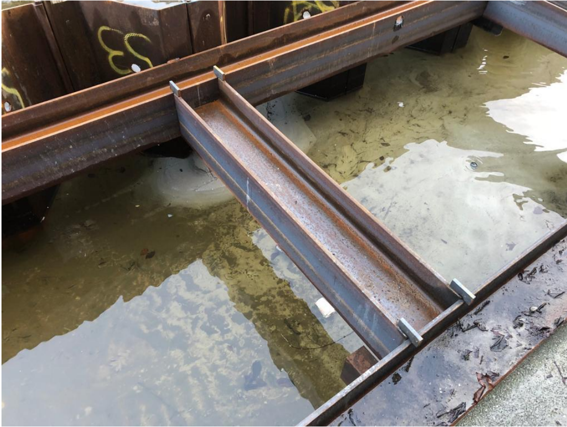
Foto 1, dit is de constructie waar men vanaf de kade op zou kunnen vallen.
