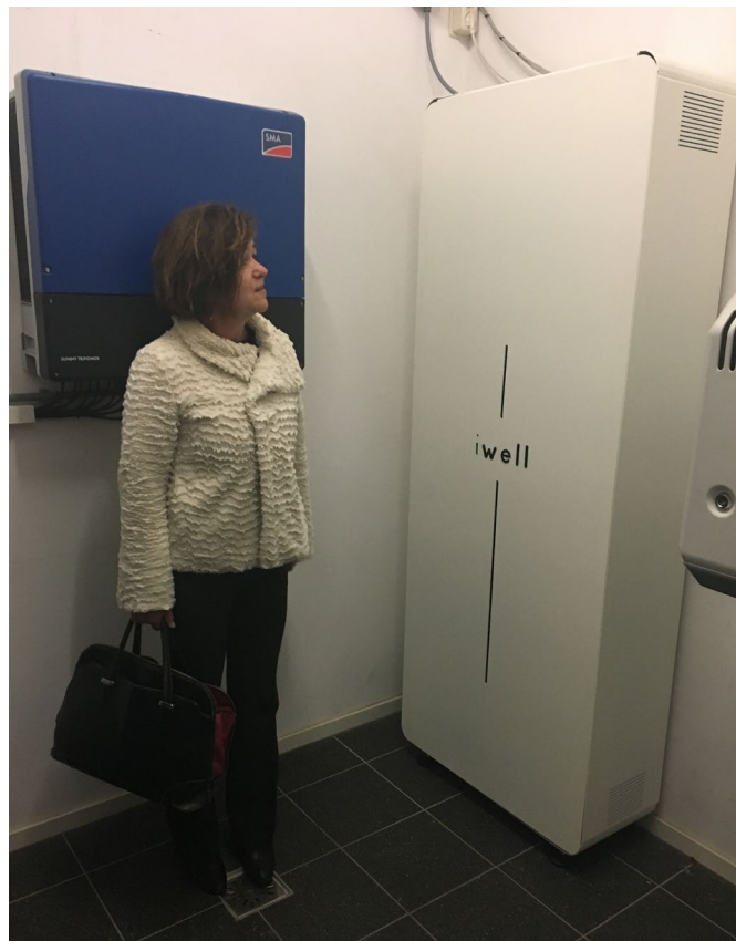
Innovaties bij PWS: batterij-opslag van energie die is opgewekt op daken van wooncomplexen Patrimonium.
